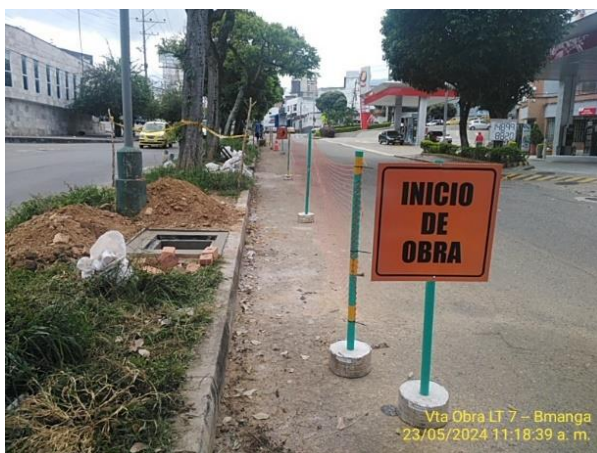
Imagen No. 1 Cajas de paso e inspección
