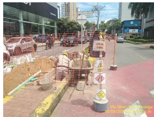
Imagen No. 2 Cajas de paso e inspección
