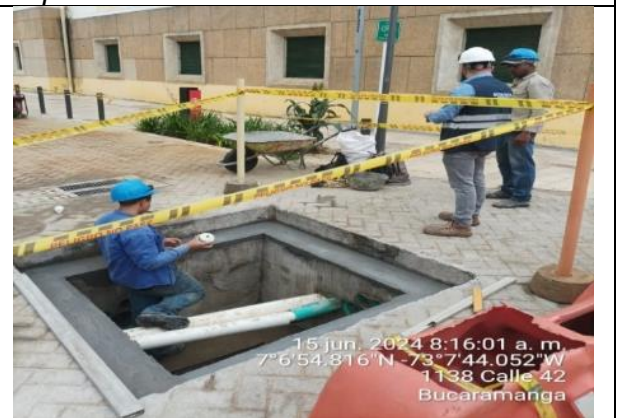
Adecuación caja eléctrica vehicular de MT
