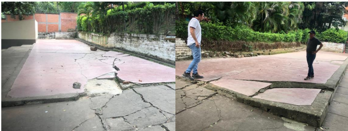
Ilustración 2. Asentamientos y grietas en el área a construir la cafetería contemplada en el alcance del contrato
